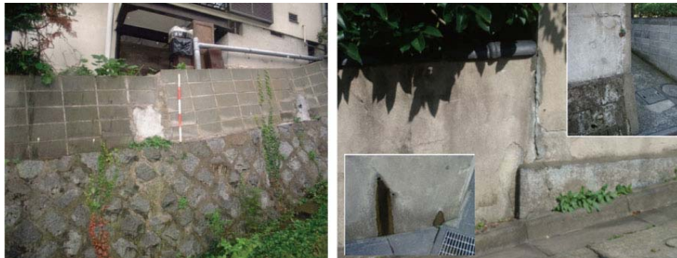
写真-1 川崎市内の谷埋め盛土造成地の変状
